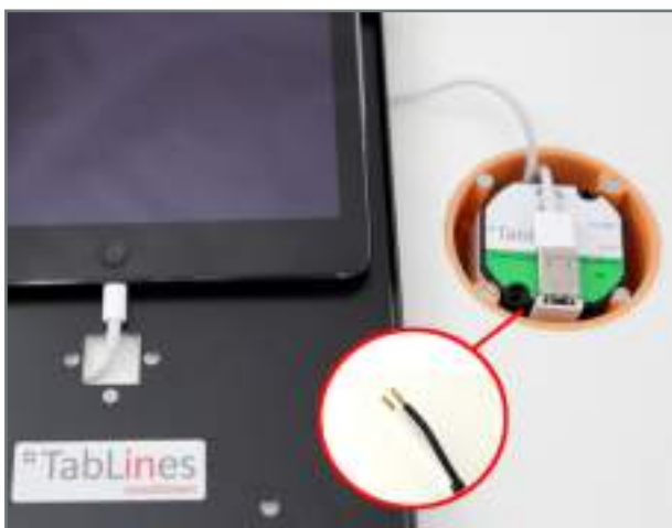
Abb. 6: Tablet im Gehäuse laden mit in der Wand eingebautem TabLines TNT001 Netzteil; Adern des Netztesiles zum Verbinden mit der Steckdose
